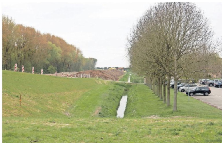
Het waterschap is niet tevreden over een deel van de dijkverzwarende en dus mag de aannemer het deel tussen de A29 en de golfbaan bij Numansdorp overdoen. (foto: Alie 't Hooft)
